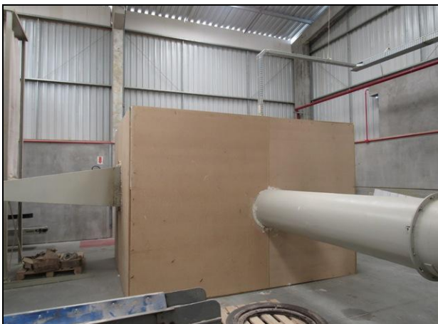
Figura 43 - Isolamento acústico do ventilador centrífugo, maior fonte de geração de ruído do empreendimento.
