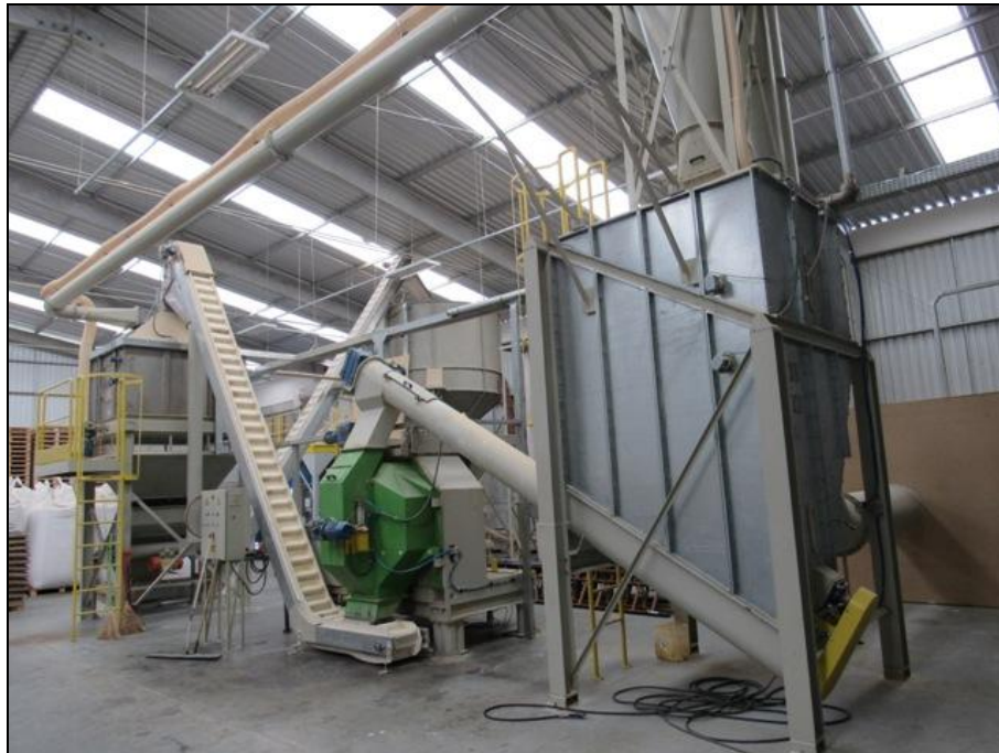
Figura 10 – Reservatório de matéria prima refinada, prensa e resfriador.
