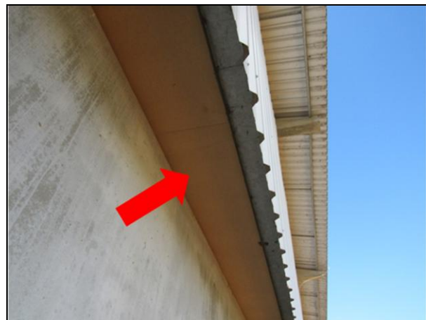
Figura 44 - Barreira acústica nas saídas livres da edificação do empreendimento - Barreiras horizontais.
