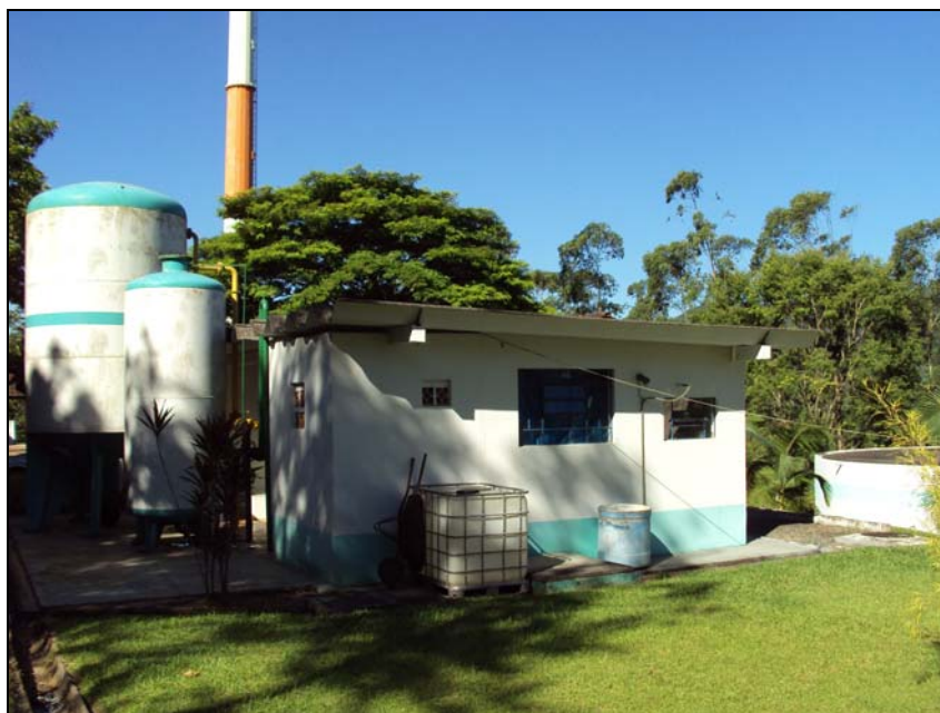
Figura 9 – Vista da ETA Compacta
