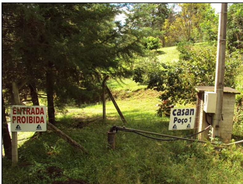
Figura 11 – Captação Sistema Alto Rio dos Cedros
