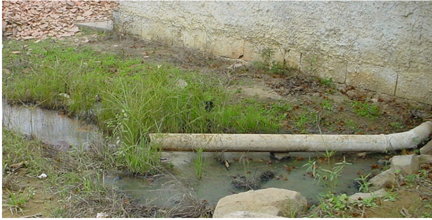
Figura 1.22: Esgoto sendo despejado na drenagem urbana.
